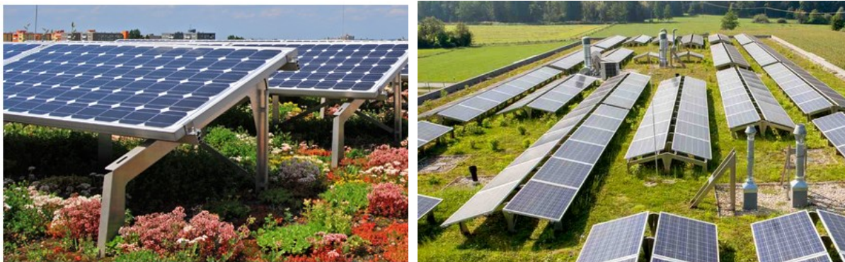
Abb. 10 Beispiel einer aufgeständerten Photovoltaikanlage mit Dachbegrünung Quelle: Bundesverband Bauwerksbegrünung/zinco
