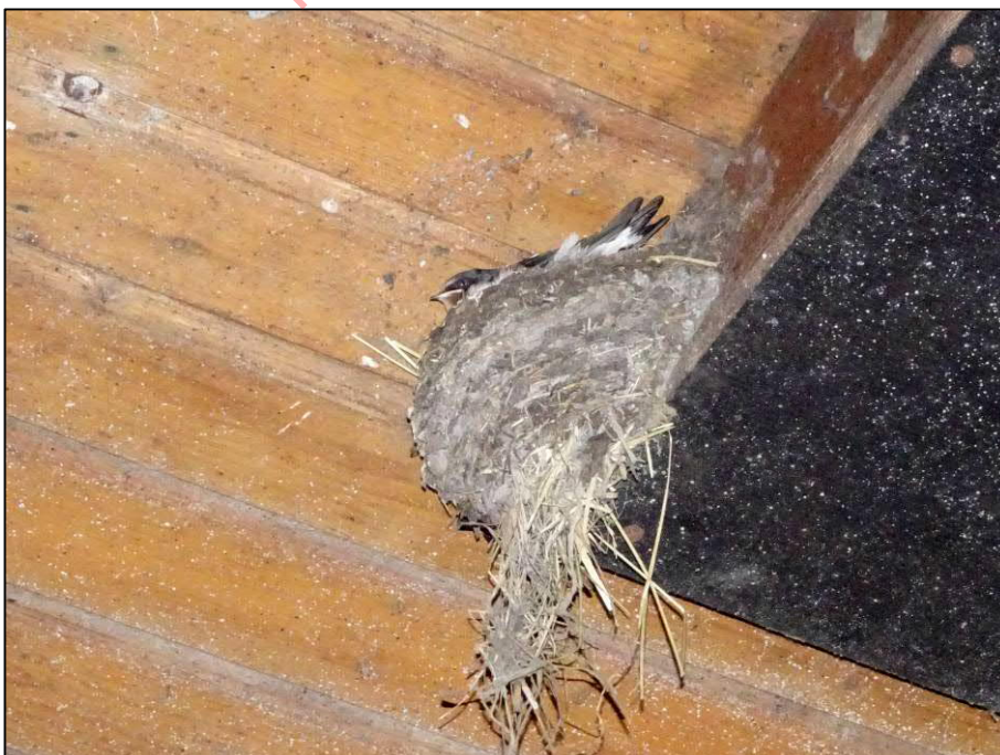
Abbildung 10 Rauchschalbennest in Rinderstall (Gebäude Nr. 4, Juli 2022)
