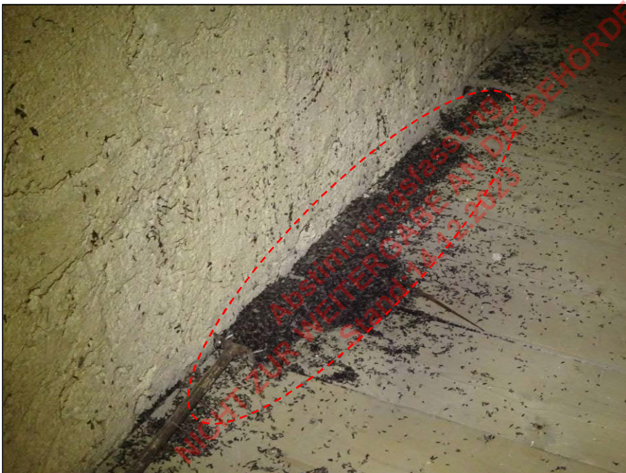
Abbildung 17 Fledermauskot an der Stirnseite des östlichen Nebentrakts des Kurhauses (August 2023)
